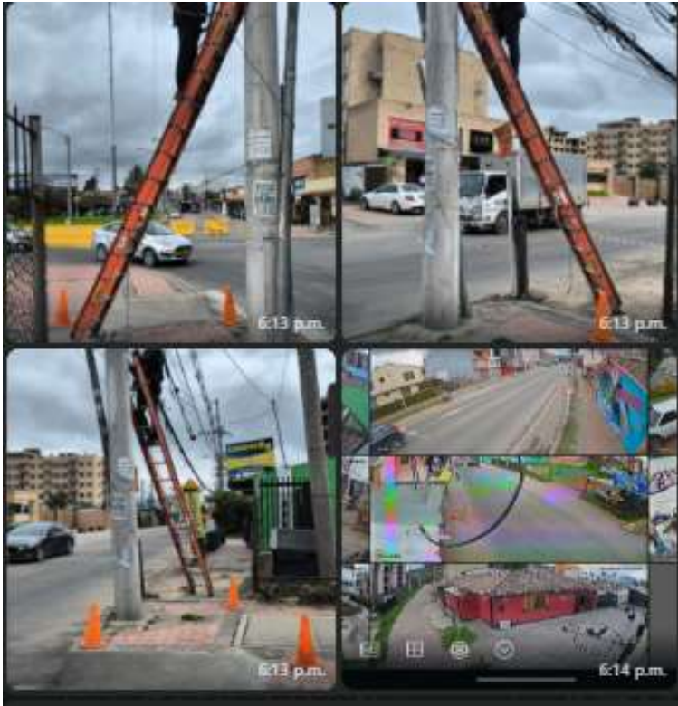
Mantenimiento de alarmas análoga junta de acción comunal DELICIAS NORTE 21/27-05-2025
