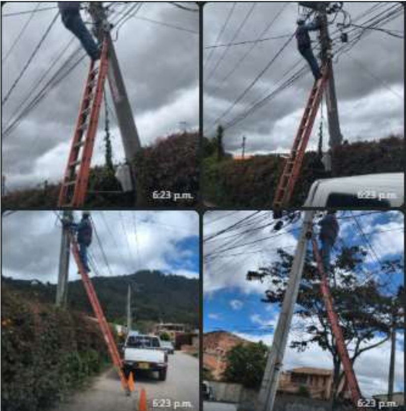
Mantenimiento de alarmas análoga junta de acción comunal SIATA 03-06-2025
