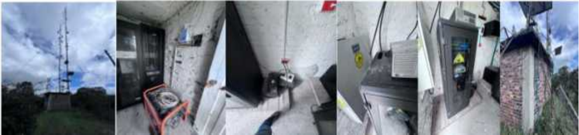
Ilustración 1, Fotografía Espacio Torre para la instalación de Antenas para mejorar la Seguridad
