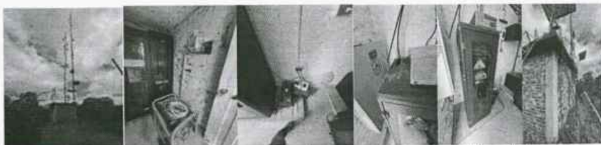
Gráfico 7, Fotografía Espacio Torre para la instalación de Antenas para mejorar la Seguridad
