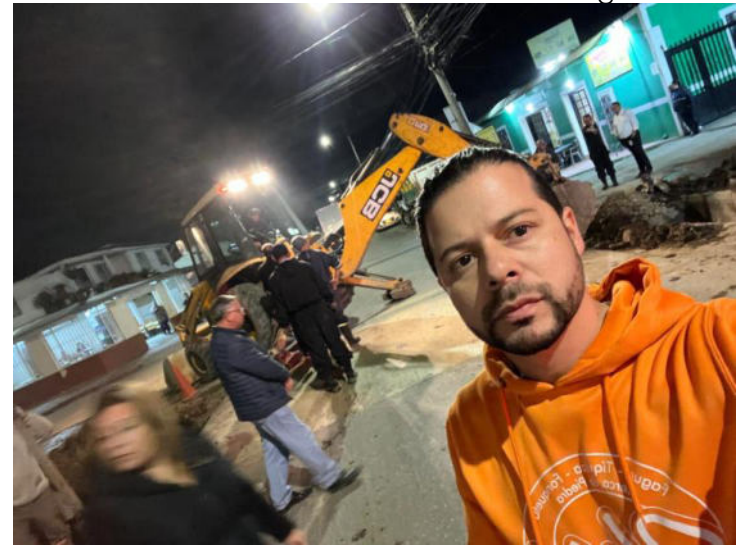
Cubrimiento daño tubería EMSERCHÍA domingo 13 de abril
