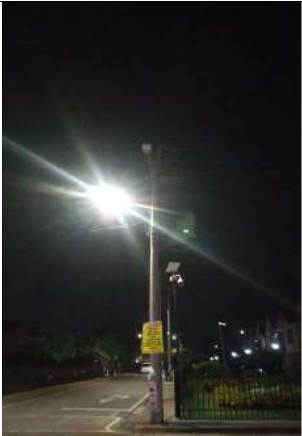
Caracterización de un elemento de alumbrado público "UCAP", Ubicado en la JAC la primavera, estado del elemento LUMINARIA APAGADA, se caracteriza como "Luminaria por mantenimiento".
